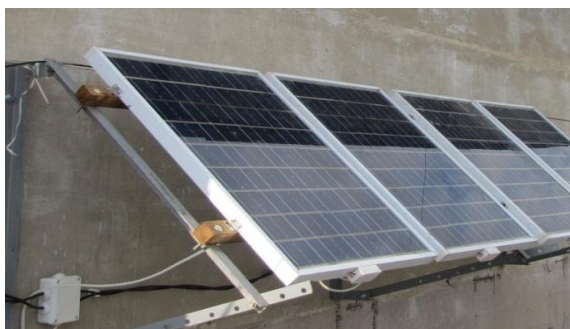
Рисунок 1 – Загальний вигляд сонячних панелей
