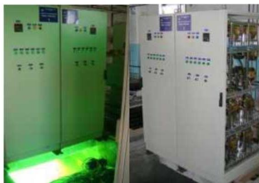
Рисунок 1.8. Шафи ПРА для живлення УФ-ламп, які встановлені в касетах В6КС.01
