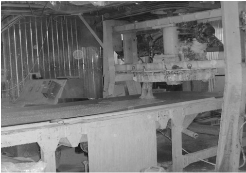
Рис. 7. Фрагмент технологічного обладнання, яке забезпечує процес підготовки гіпсоводної суміші та подачі її на формувальний стіл
