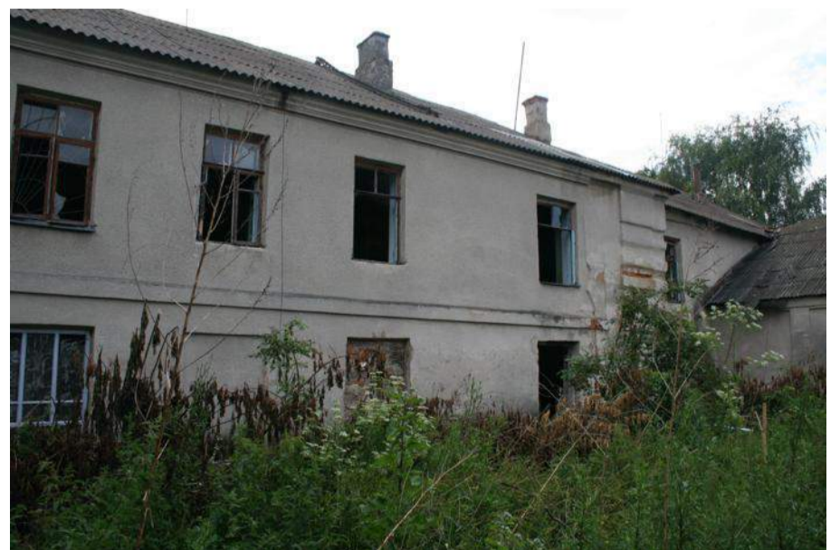
Меджибіж. Площа Ринок. Фото 2007 р. Приклад неналежного ставлення до караван-сараю XVII ст.
